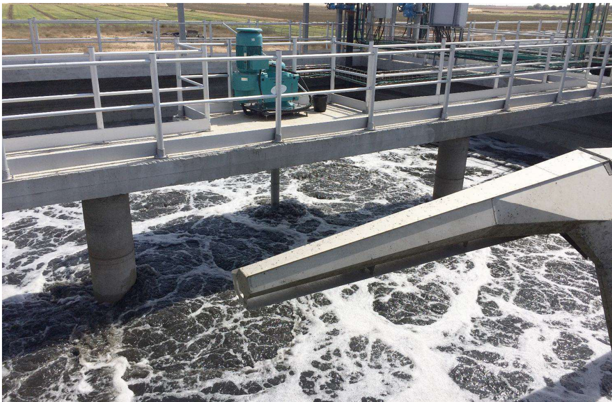
Abbildung 1: Abwasserreinigungsanlage in Israel mit iSBR ®
